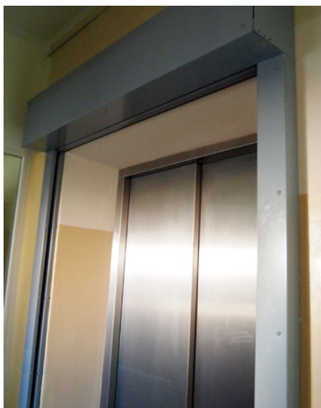
Kurtyna ppoż. przy drzwiach dźwigu
